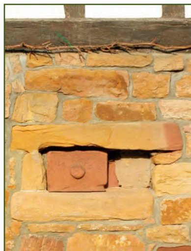
Ouvertures créées dans les soubassements pour l'aération des caves. La fermeture est en grès et coulisse horizontalement.
