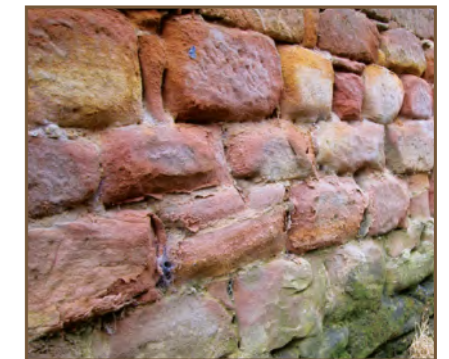
Mur en moellons de grès dégradé par l'humidité et les attaques bactériennes.
