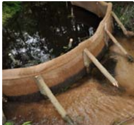
Filtre à sédiments* en fibre de coco, celui-ci permet de capter les matières en suspension dans l'eau et faciliter leur dépôt
