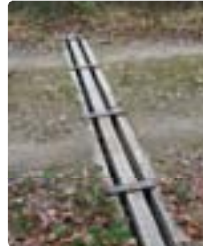
Rigole de dispersion des écoulements sur chemin camionnable afin de limiter l'érosion
